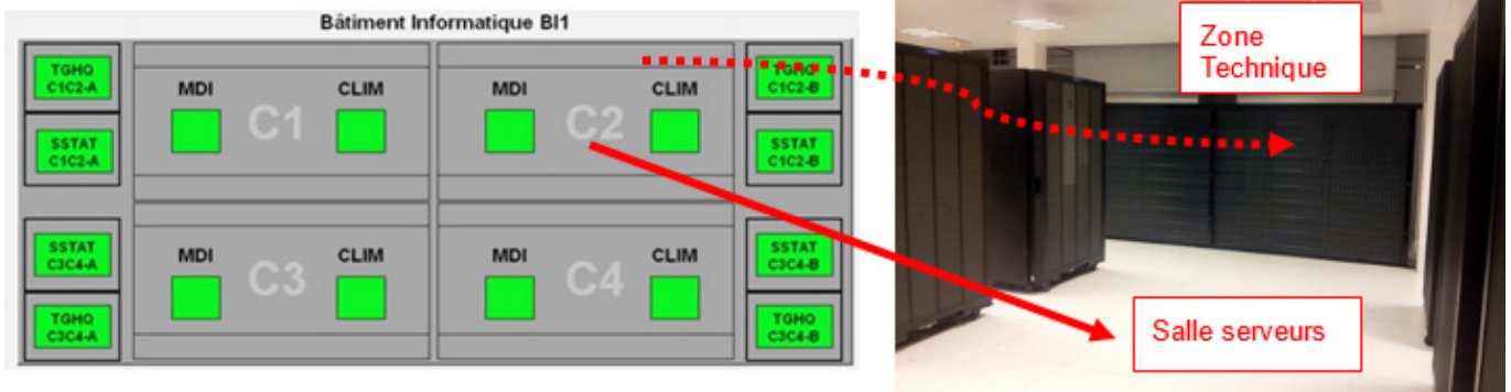
Figure 9 : Vue d'une salle serveur sur la Gestion Technique Centralisé / Photo salle serveur
